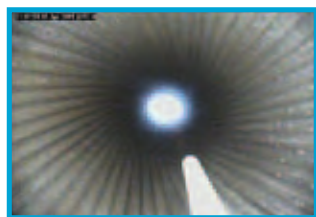
Dopo il trattamento
