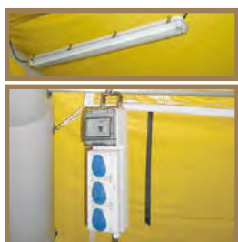
Impianto elettrico e di illuminazione.
