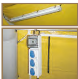
Impianto elettrico e di illuminazione.
