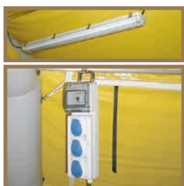
Impianto elettrico e di illuminazione.
